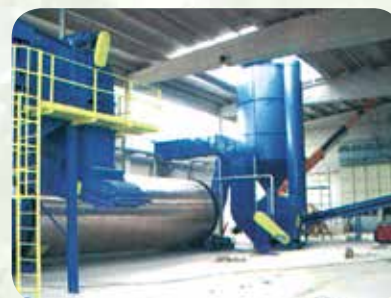
Impianto di trasformazione
